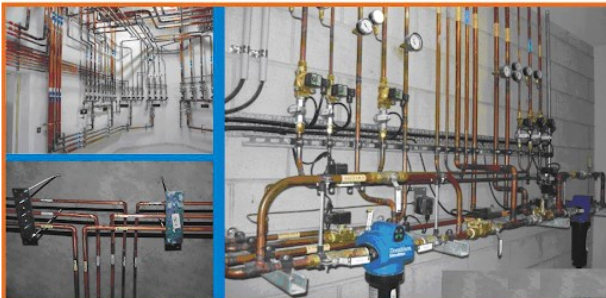
Hệ thống ống dẫn khí
