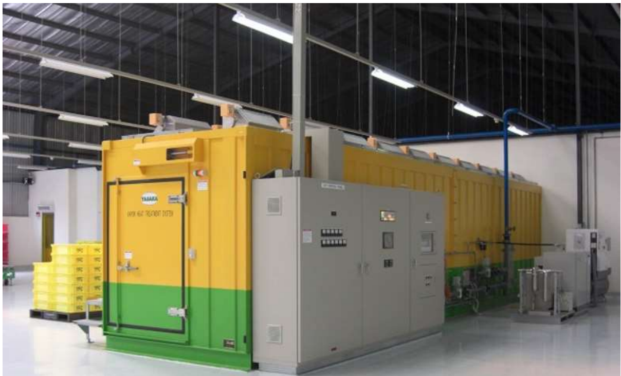
Hệ thống máy móc VHT
